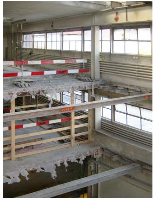
Der Umbau des Industriedenkmalms stellte die Beteiligten immer wieder vor neue Herausforderungen. (Abb. 30)
